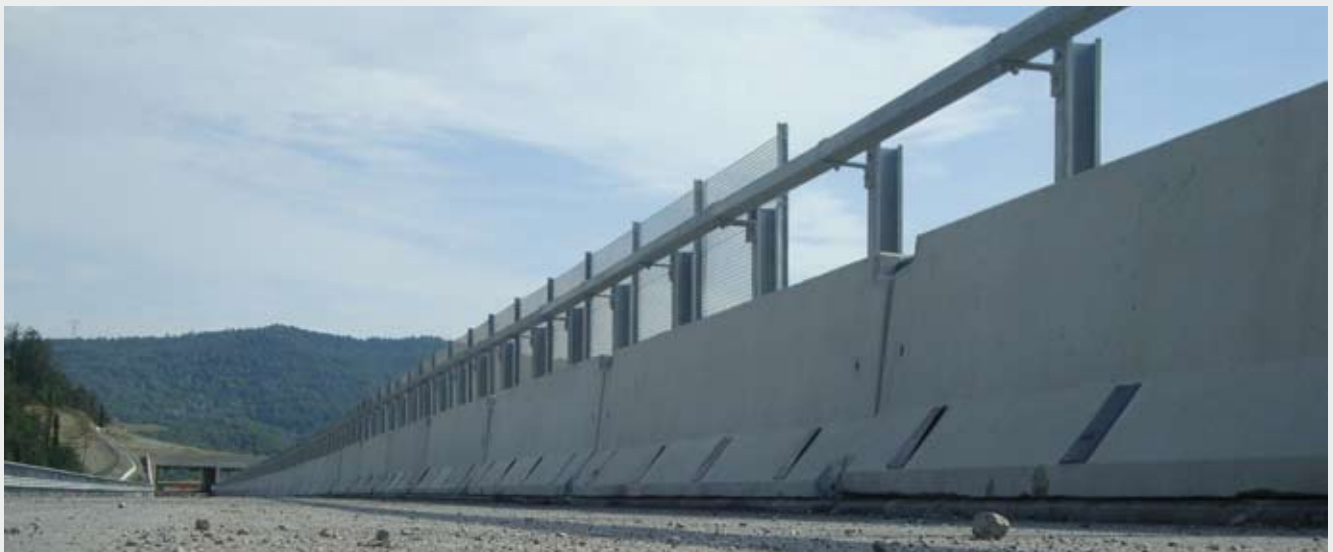
Barriera Bordo Ponte
