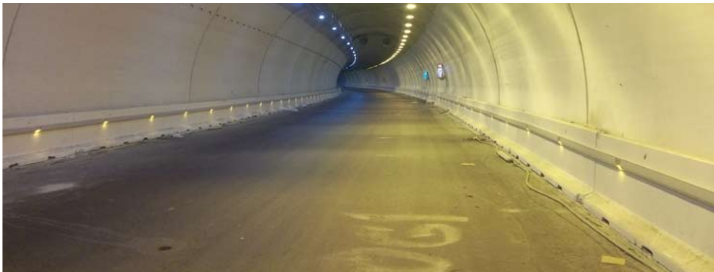
Barriere redirettive galleria Marapintau SS125 - Svincolo CapoBoi - Terra Mala (Ca)
