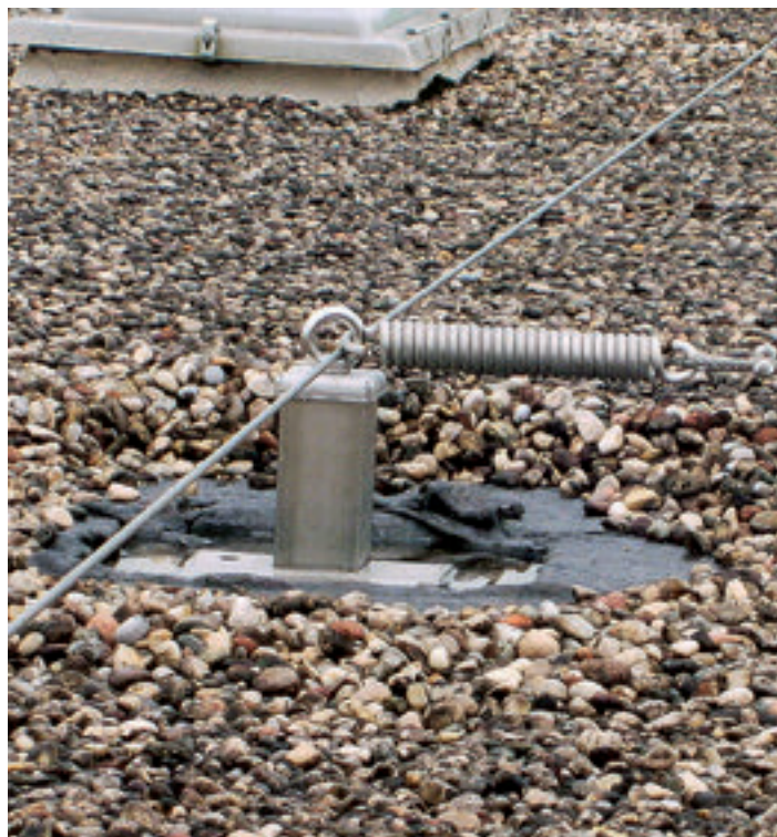
Linea vita su copertura industriale
