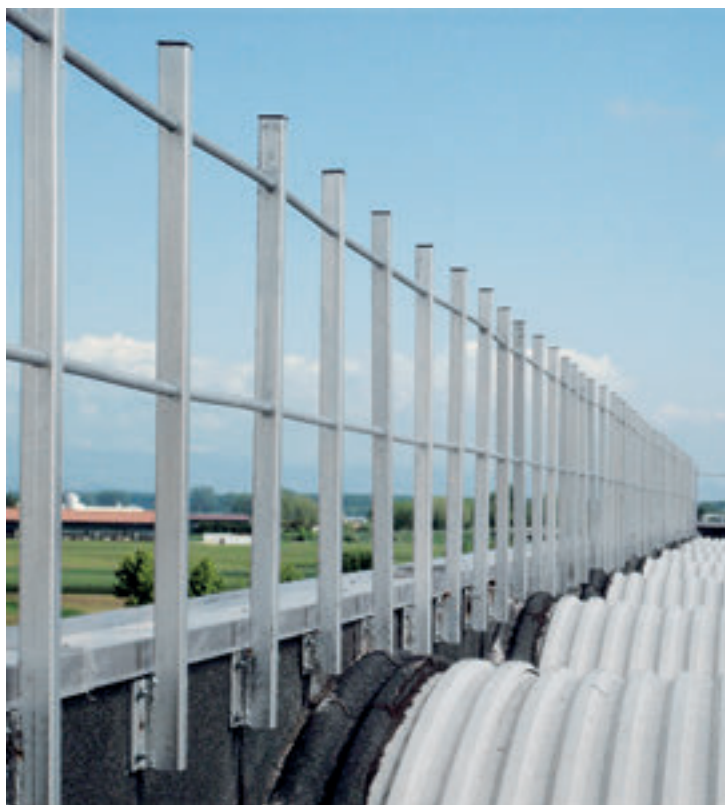
Parapetti installati presso Fomet S.p.a.
