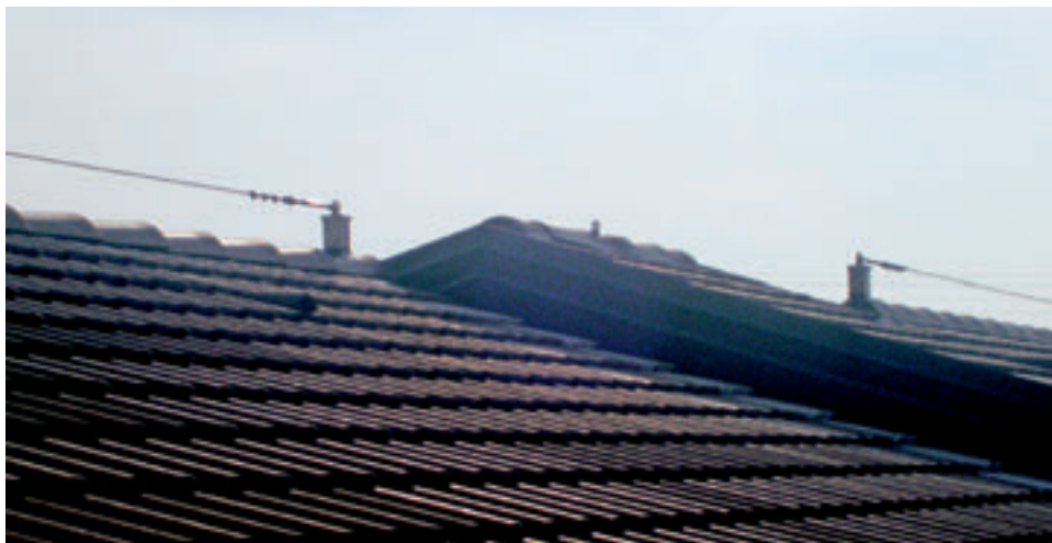
Impianto anticaduta - Centro storico Verona
