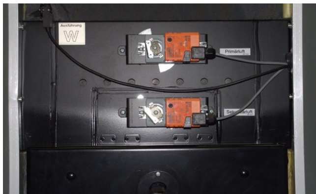
Fig.18 - Vista frontale presa aria primaria e secondaria e relativi attuatori elettrici
