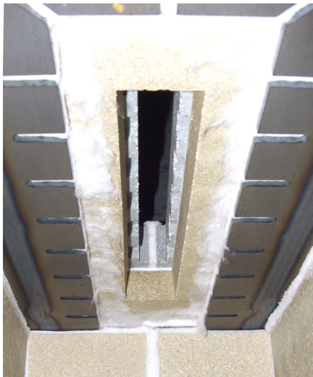
Fig.22 - Vista dal basso camera di combustione e feritoia passaggio fiamma
