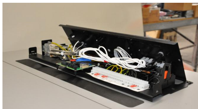
Fig.24 - Dettaglio centralina di regolazione
