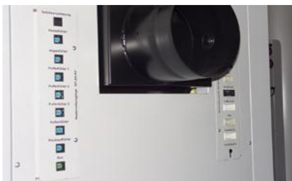
Fig. 21 - Morsettiere posteriori a bordo macchina riservate alle utenze elettriche
