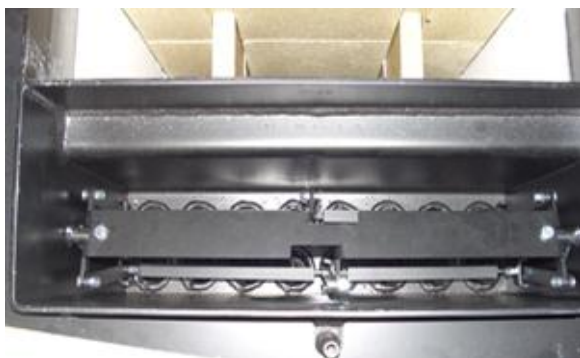
Fig. 19 - Vista dall'alto scambiatori verticali con turbolatori
